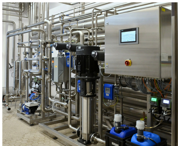
Kompakt auf einem Rahmengestell montiert: Die Grünbeck-Wasseraufbereitungsanlage in der Brauerei Frastanz. Ihr Herzstück ist die Umkehrosmoseanlage GENO-OSMO-RKF 12.500, die pro Stunde bis zu 12,5 m 3 vollentsalztes Wasser liefert, das in der nachgeschalteten Verschnideeinrichtung mit Rohwasser vermischt wird, um die optimale Brauwasserhärte zu erreichen. Bild: Grünbeck Wasseraufbereitung GmbH
